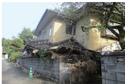
益城町 1階が押し潰されている (写真：上田)
