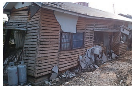
益城町 モルタル壁が剥がれている (写真：稲垣)
