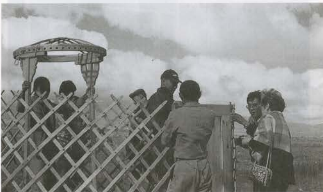
②ゲルの中央に「ハガナ」と呼ばれる柱を立てる。真南に入り口の位置を設定する。柳の枝を編んだ「ハナ」と呼ばれる壁を床板にあわせて広げる。扉の西側から右回りに組み立てるしきたりらしい。これの広げ方によってゲルの天井の高さが決まる。
