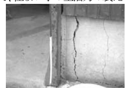
基礎(無筋)の亀裂
