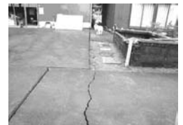
建物が相互接触をした原因と思われる地割れ
