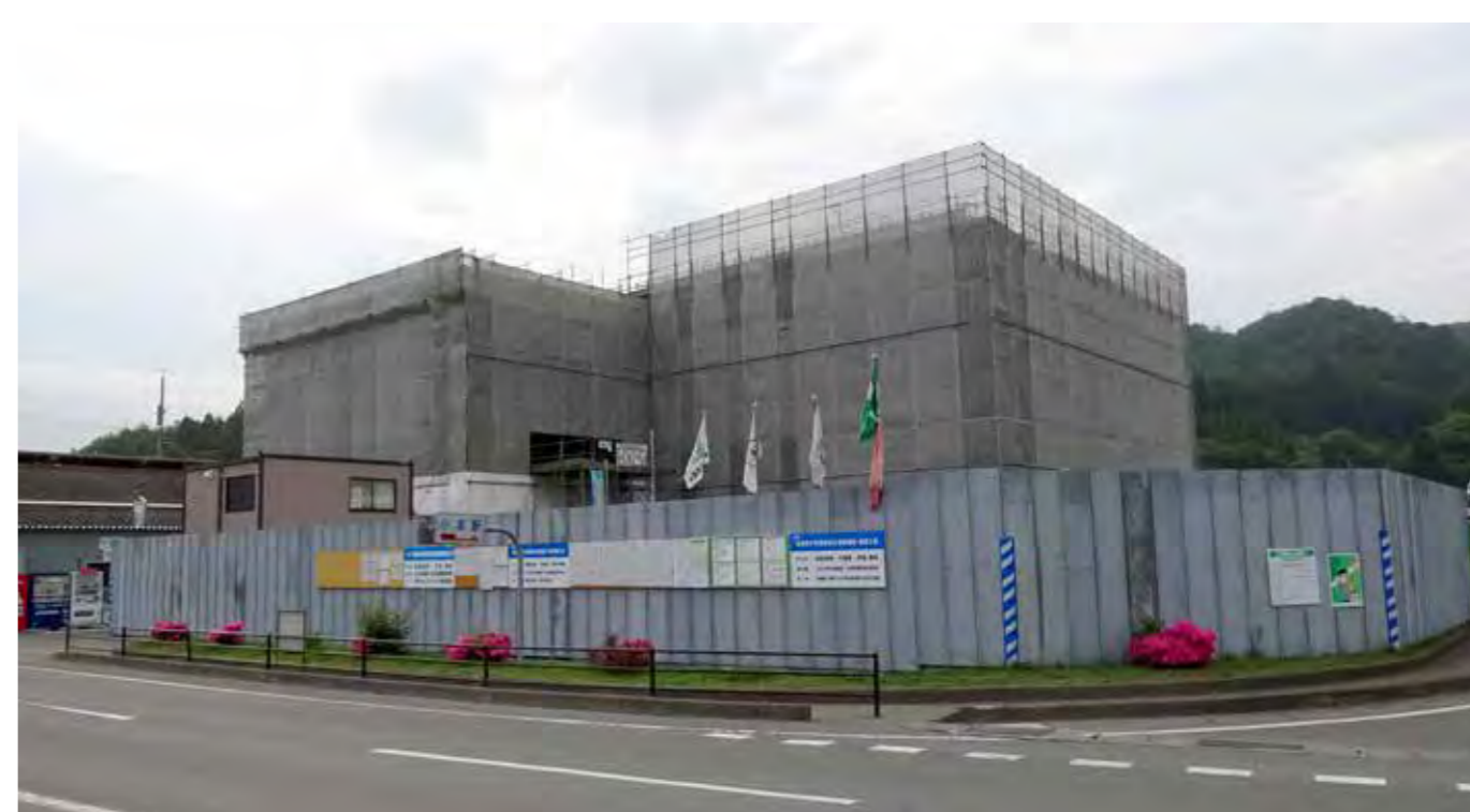
小本津波防災センターの全貌が立ち上がって来た工事現場
