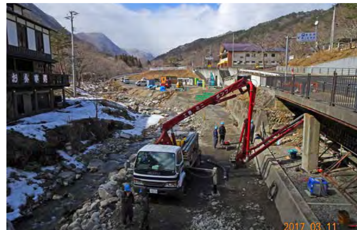
台風10号の爪痕 急ピッチで進む龍泉洞付近の整備復旧工事
