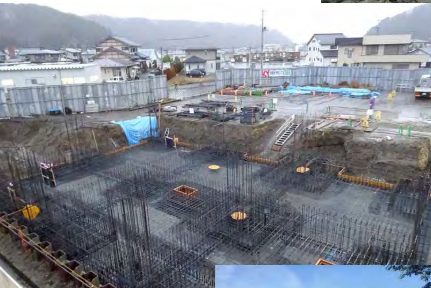
11月、杭・基礎工事を終え、立上り躯体工事が始まっている。
