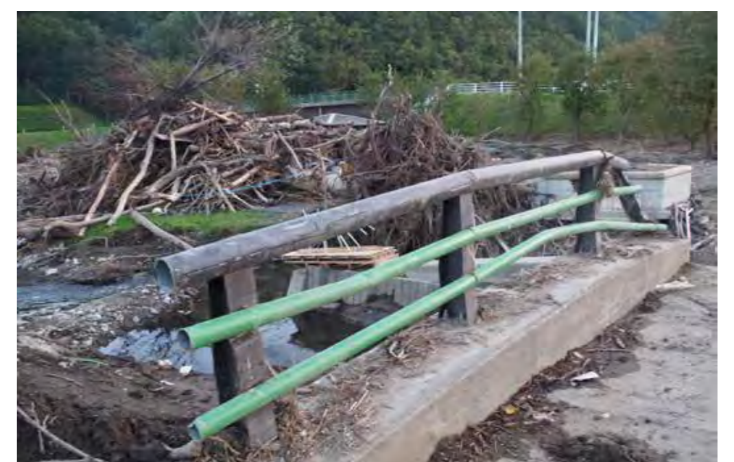
小本川氾濫後の岩泉乳業前の橋の被災状況
