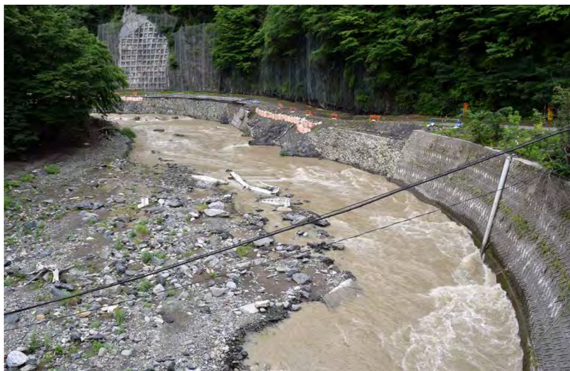
未だ護岸が崩れたままの小本川
