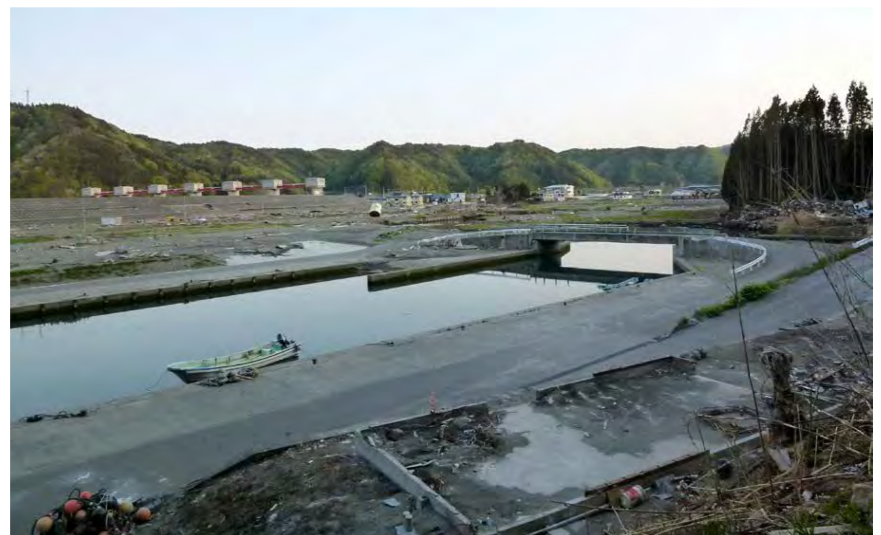
破壊された小本漁港から水門を望む
